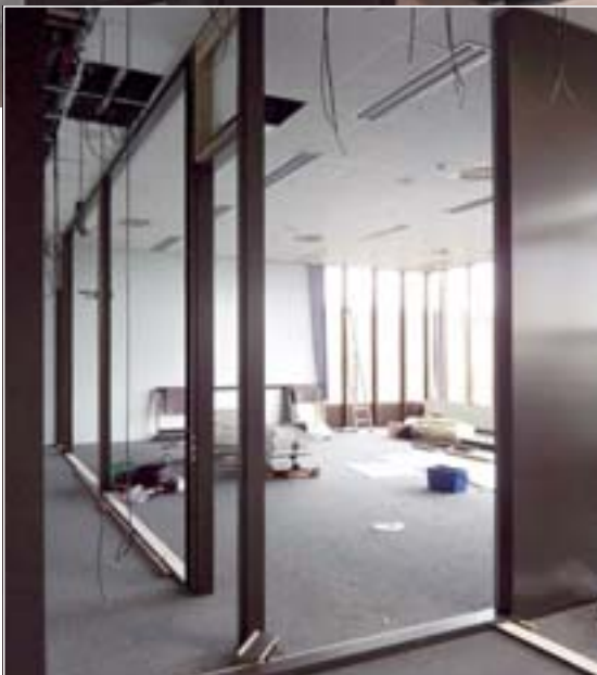
Bauen im Bestand: Die selbst entwickelte Trennwand aus MDF und VSG ist zwischen abgehängter Decke und Doppelboden montiert
